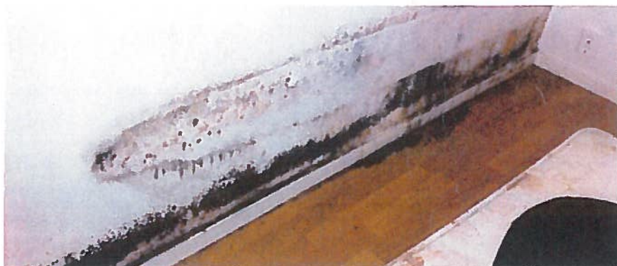
FUKTSKADE: Misfarging og svarte prikker bak møblene er tegn på fuktskader. (Foto: Effecta)
